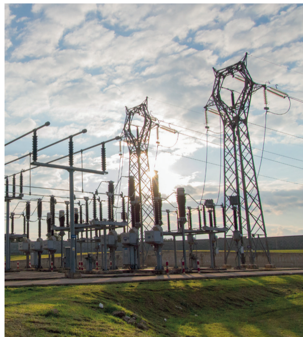
Cabina primaria di distribuzione elettrica
